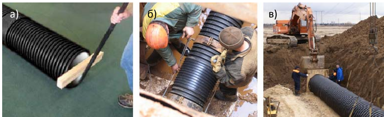
Рисунок 3. Монтаж муфтового (раструбного) соединения с помощью специальных приспособлений (а – рычага, б – лебедочного механизма, в – домкратом, упертым в неподвижный ковш экскаватора, либо, ковшом экскаватора)
